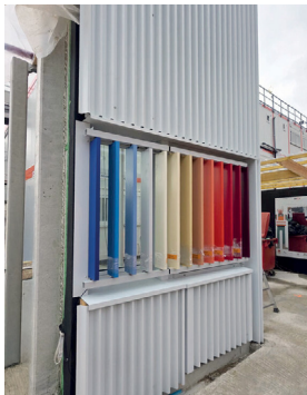
Technicentre Sud Est Européen 4.0 – Bâtiment multiservice (BMS) – Prototype de façade. © AREP, octobre 2025
