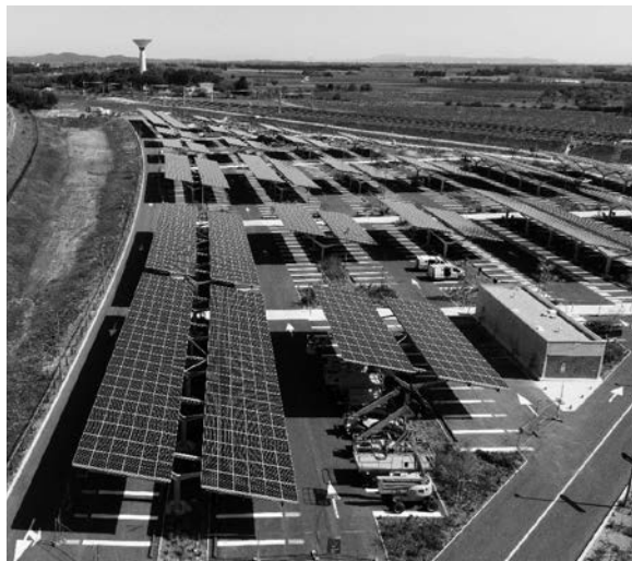
Parking sous ombrières de panneaux photovoltaïques, gare de Nîmes Pont-du-Gard TGV.
